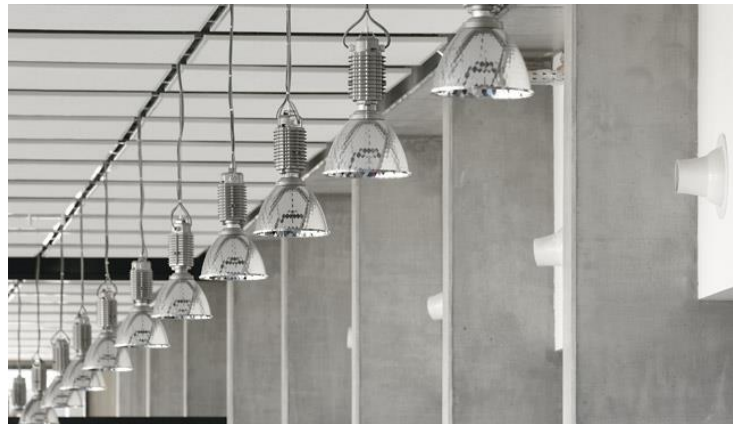
Figuur 3: halreflectorarmatuur Copa D in het restaurant
